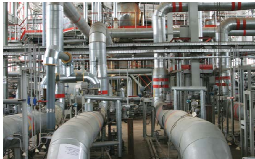
ПГУ-235 МВт ООО «ЛУКОЙЛ-Астраханьэнерго»
