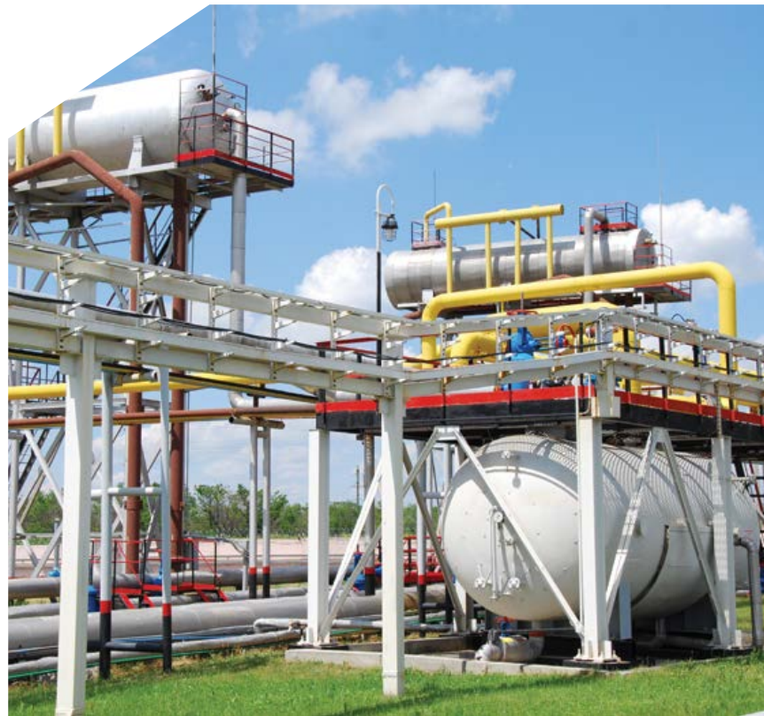
ОАО «РИТЭК». Установка приёма и перекачки нефти
